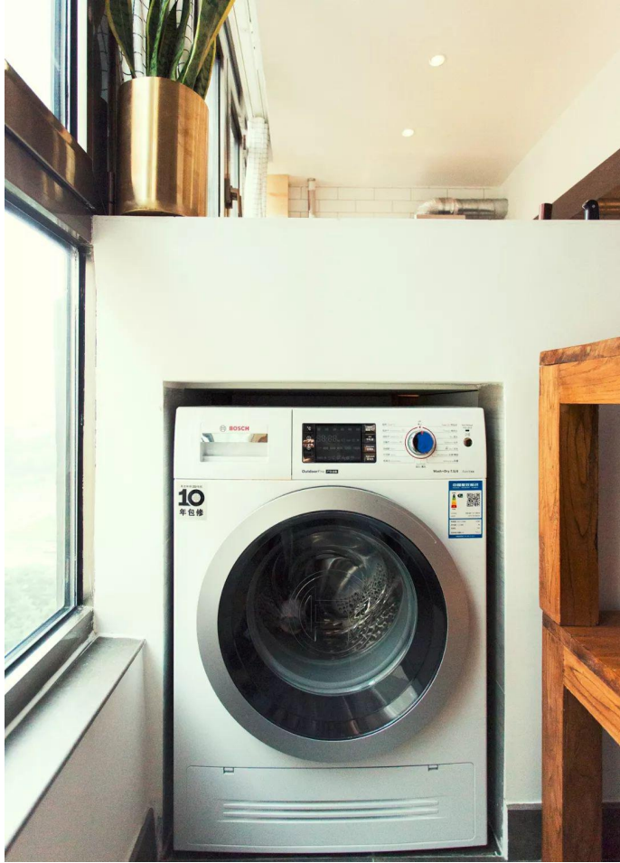
▲安装在橱柜台面下的滚筒洗衣机
